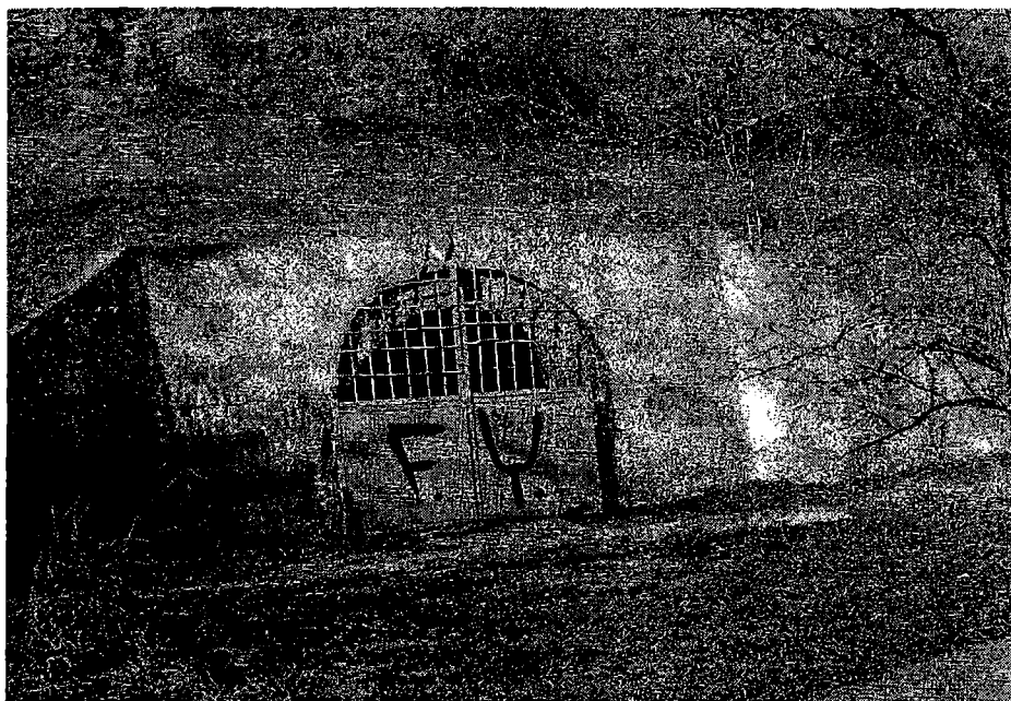
Рис. 6. Вывод подземных вод из дренажной галереи
